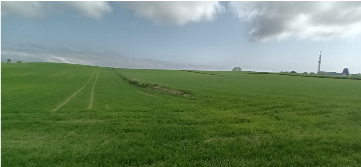
Figur 4. Digegennembrud i D00.013.307 – Tilsyn den 9-10-2023.
